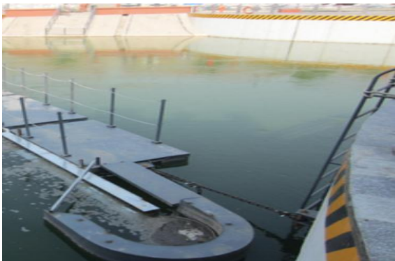
■干渠油污拦截导流清除装置
