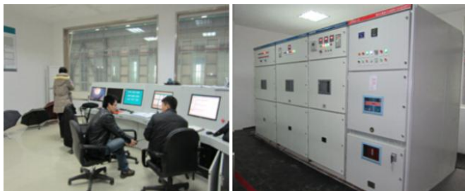
■ 广西苍梧县下小河泵站 4 台 1200kW （中国最大潜水泵站）
