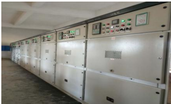
■ 湖南利欧泵业 10000kW/ 10KV 水泵电机起动平台 （亚洲最大水泵测试平台）
