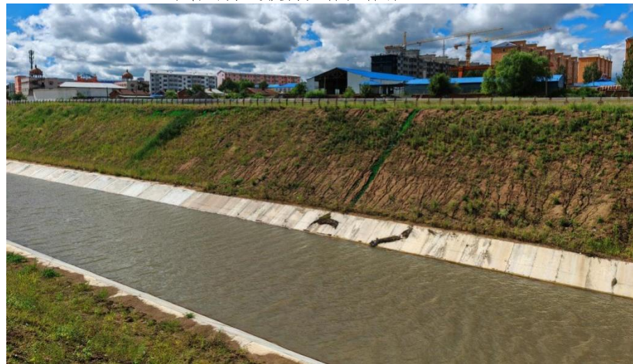
部分干渠边坡植草防护（冲刷）需补植补种
